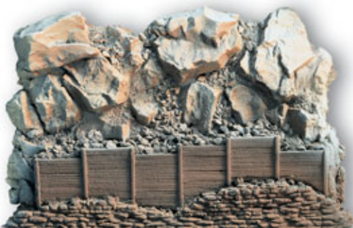
Steinschlag-Schutzwand auf Natursteinmauer
